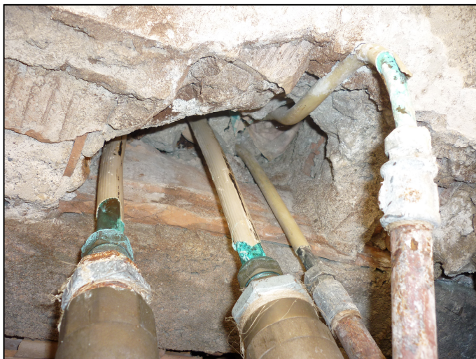
Foto 2: tibazioni in rame dell'impianto di riscaldamento.
