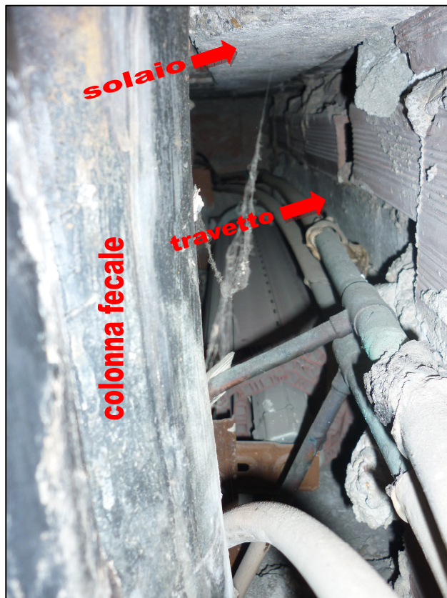
Foto 3: tubazioni dell'impianto di riscaldamento posizionate all'interno del cassonetto delle tapparelle.
