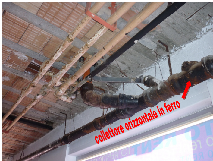
Foto 5: collettore di adduzione orizzontale presente nei locali al piano terra.
